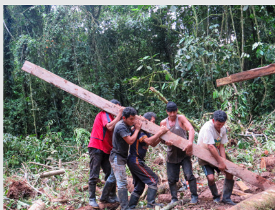
Miembros de la comunidad La Primavera construyen un puesto de control en su área de conservación 'Jardines Angel del Sol'. (Foto: Ignacio Auger)
